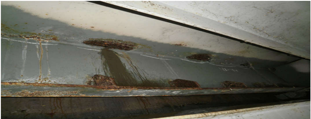
Рис. 15. Корозія металу ортотропної плити в місцях наскрізного пропалення металу
